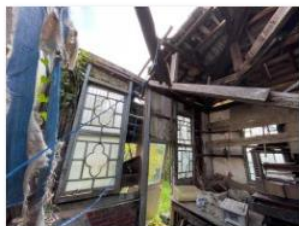
嘉星醫院故居_內南廂房2屋頂破損 (2)
