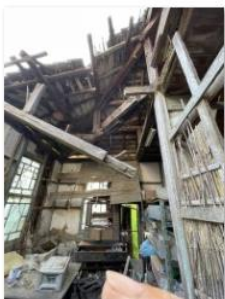
嘉星醫院故居_內南廂房2屋頂破損 (4)
