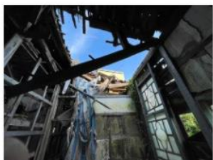
嘉星醫院故居_內南廂房2屋頂破損 (5)
