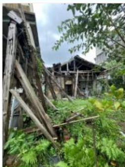
6嘉星醫院_2樓後撤倒塌
