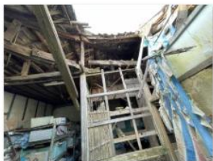
嘉星醫院故居_內南廂房2屋頂破損 (3)
